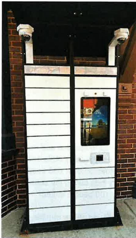
Actual install at Romeo
